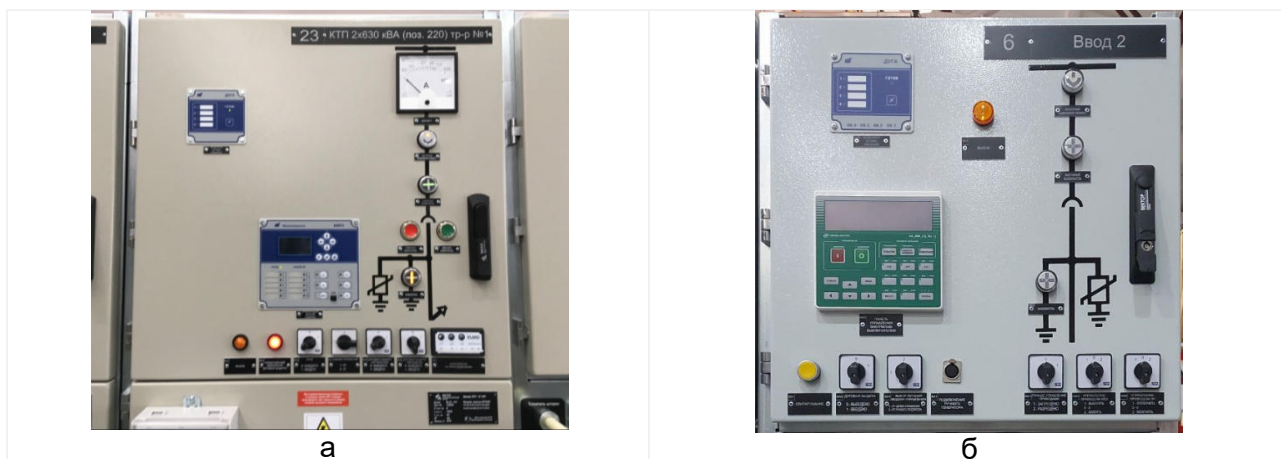
Рис.2.11 Фасад отсека вспомогательных цепей с органами местного управления а-исполнение с ТТ, б-исполнение с КДТН
