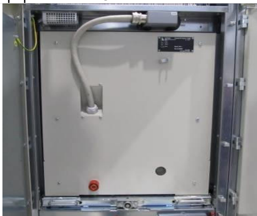
Рис.1.22 КВЭ в контрольном положении (вид при открытой двери)
