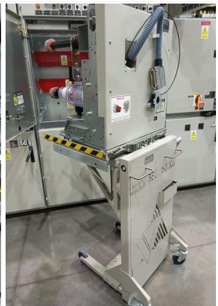
Рис. 2.19 КВЭ в ремонтном положении
