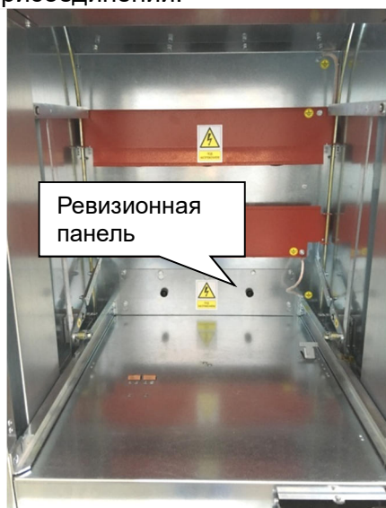
Рис. 1.5 Отсек выдвижного элемента при извлеченном КВЭ
