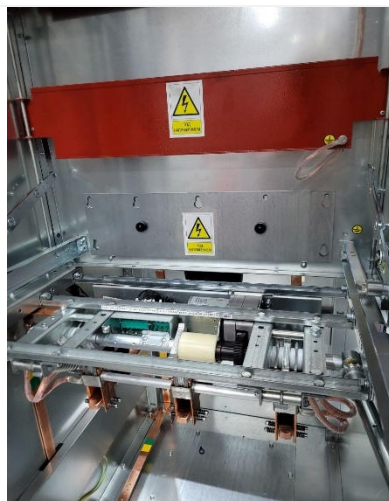
Рис.1.8 Электропривод заземлителя без защитного кожуха
