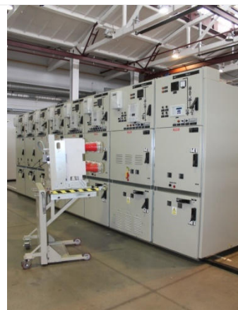
Рис.1.23 КВЭ в ремонтном (сервисном) положении
