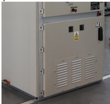
Рис. 1.53 Вентиляционные отверстия в двери отсека присоединений
