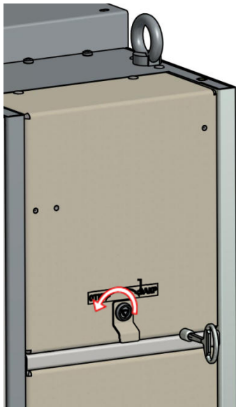
Рис.7.9. Открытие дверей отсека вторичной коммутации шкафа ШС
