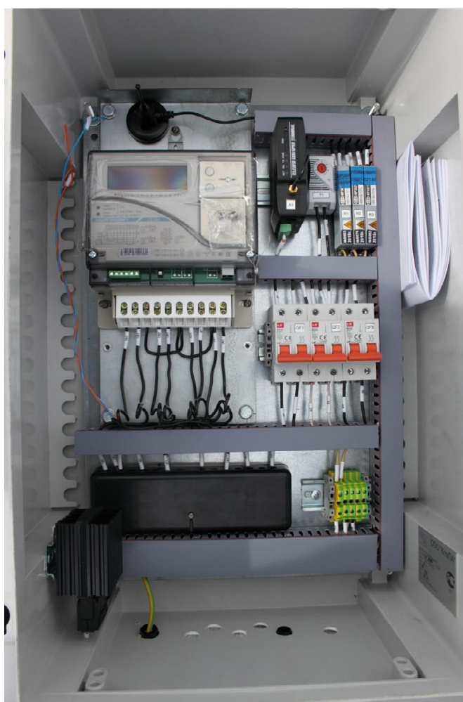
Рис. 4.54. Смонтированный счетчик электроэнергии в шкафу учета
