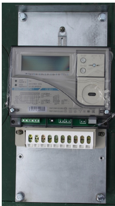
Рис. 4.53. Счетчик электроэнергии, установленный на малой монтажной панели
