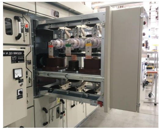
Рис.1.5 Положение технического обслуживания моноблока
