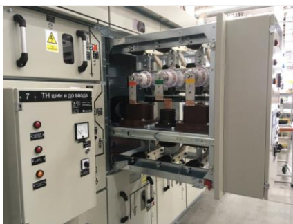
Рис.3 Положение технического обслуживания моноблока
