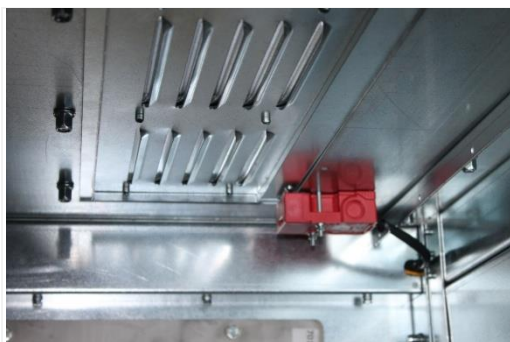
Рис. 13 Концевой выключатель в отсеке сборных шин ВССШ
