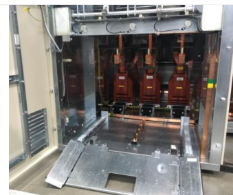
Рис. 7 Отсек присоединений ВССШ
