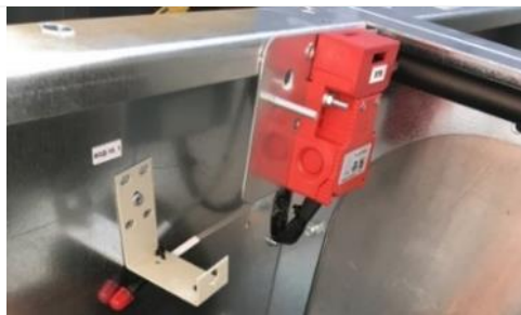
Рис. 19 Комбинированная защита от дуговых замыканий (клапанная и волоконно-оптическая) в отсеке сборных шин
