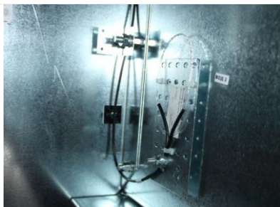
Рис. 18 Волоконно-оптический датчик в отсеке присоединений
